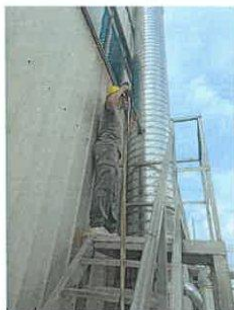
挤出、覆膜废气排气筒出口
