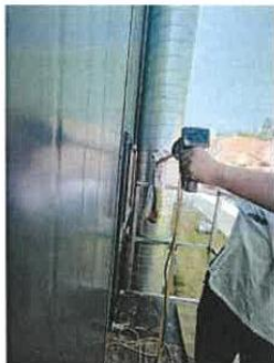
喷漆废气排气筒出口
